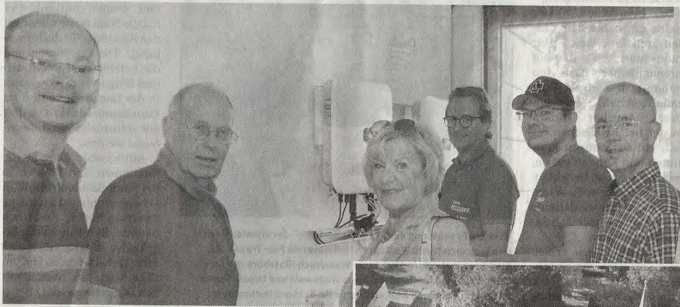
Gehen beim Klimaschutz gemeinsam voran: Klimamanager Markus Kaulbars, Swen und Gundl Busse mit Pfarrer Udo Arnoldi und Mitarbeitern der ausführenden Firma Elektro Beckhoff.
